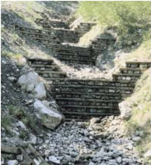
Abb. 7d: Gebirgsbach mit künstlichen Abstürzen zur Geschiebereduktion und Stabilisierung von Ufer und Sohle
