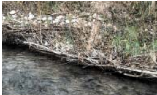
Abb. 4a: Gewässer mit durchlässiger Verbauung des Böschungsfusses: Lebendverbau; es sind geflochtene Weidenäste zu erkennen, die auszuschlagen beginnen und bald mit ihren Wurzeln die Uferböschung sichern.
